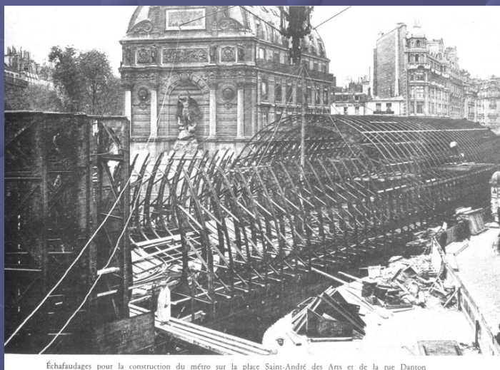
Échafaudages pour la construction du métro sur la place Saint-André des Arts et de la rue Danton
